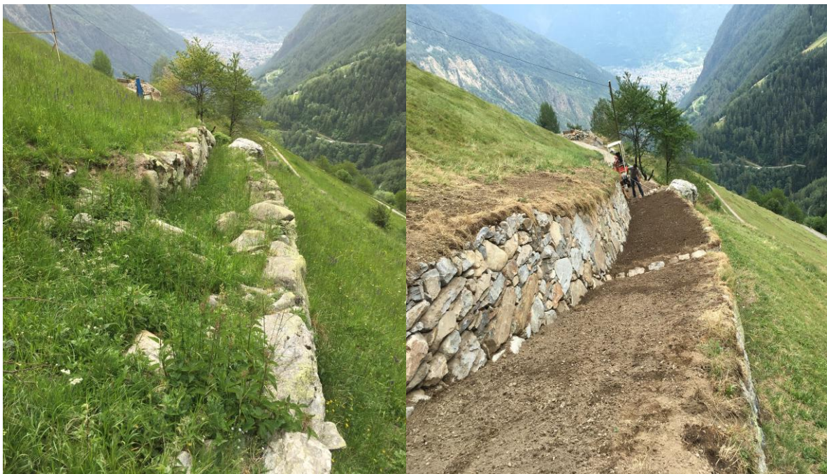
Links: Weg zwischen den Terrassen komplett zerstört; rechts: während der Restaurierungsarbeiten.
